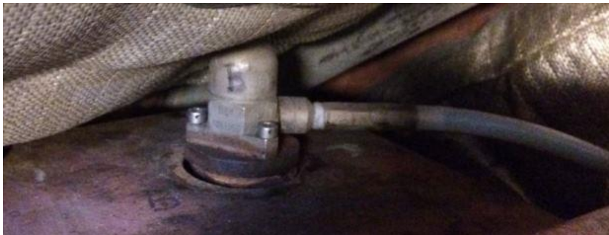
Figur 5-17. Accelerometer (sensor) på turbinens leje ved lavtryksenden mellem turbine og gear.
